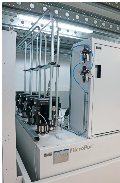
4 Sonderwunsch: Anders als bei klassischen Zentralanlagen ist bei Schnabelt jeder Schleifmaschine eine Reinölpumpe mit separater Zuleitung zugeordnet © Knoll
